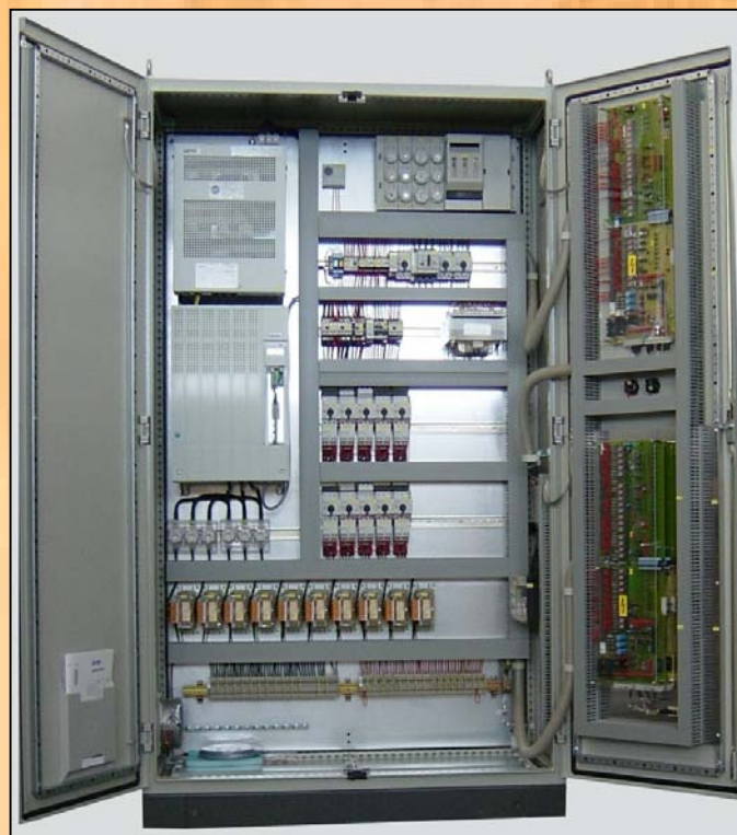
Starkstromschaltschrank mit integriertem Frequenzumrichter und Filtereinheiten zur Drehzahlregelung der Umluftventilatoren (Einsparung elektrischer Energie).
